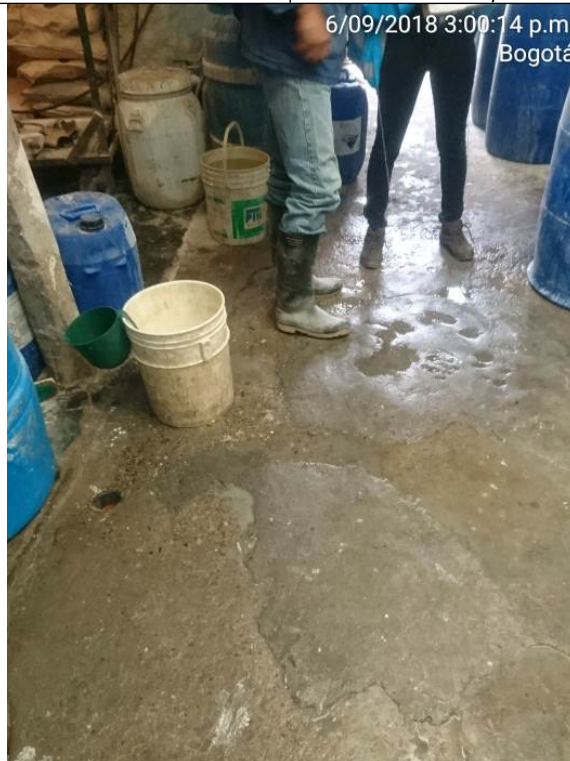
Foto No. 3 Sifón en el área de preparación de insumos químicos
